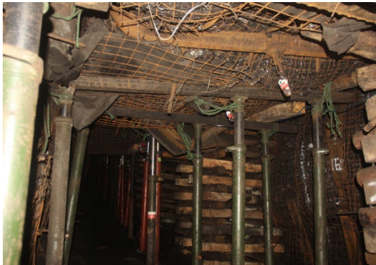
两帮收敛、顶板下沉
