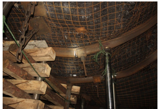
顶板下沉、锚索梁开裂
